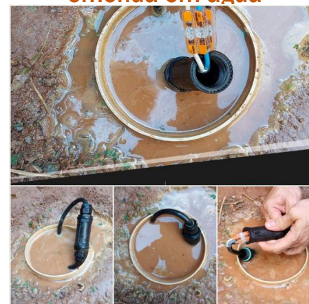
Cabo + conector de emenda em água
