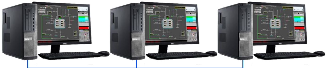
Estações de Supervisório FTView SE
